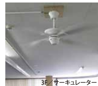
3F/サーキュレーター
